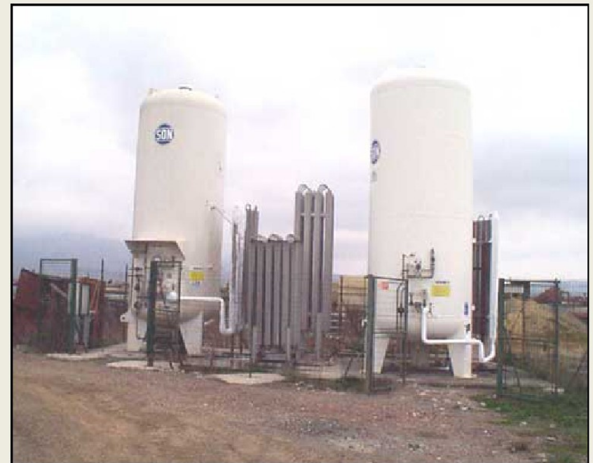
Serbatoi di ossigeno liquido
